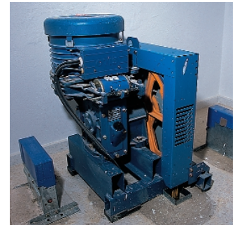
14. Maquinaria de ascensor.
