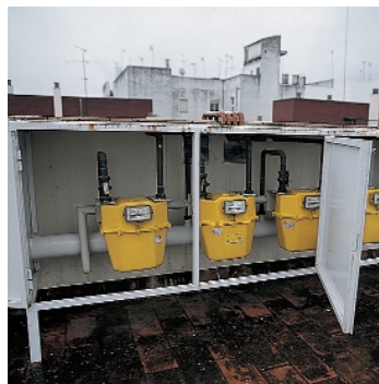
20. Batería de contadores y llaves de corte.
