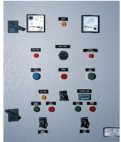
8. Frente del cuadro de control, mando y protección del grupo de presión de las BIE.
