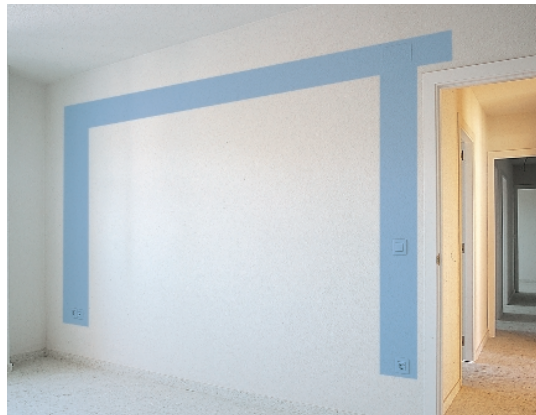
24. Bandas por donde discurren las instalaciones. Salón.
