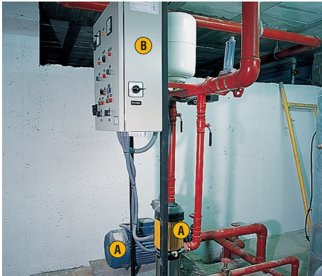
7. Grupo de presión para red de bocas de incendio equipadas (BIE): A. Electrobombas. B. Cuadro de control, mando y protección.
