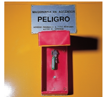
15. Puerta de entrada a sala de máquinas con su llave de acceso.
