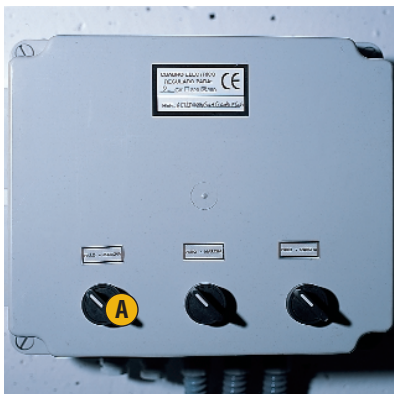
5. Cuadro de mando de electrobombas: A. Mando paro-marcha de electrobombas.
